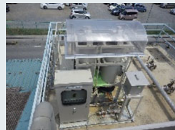
「パイロットプラント」
